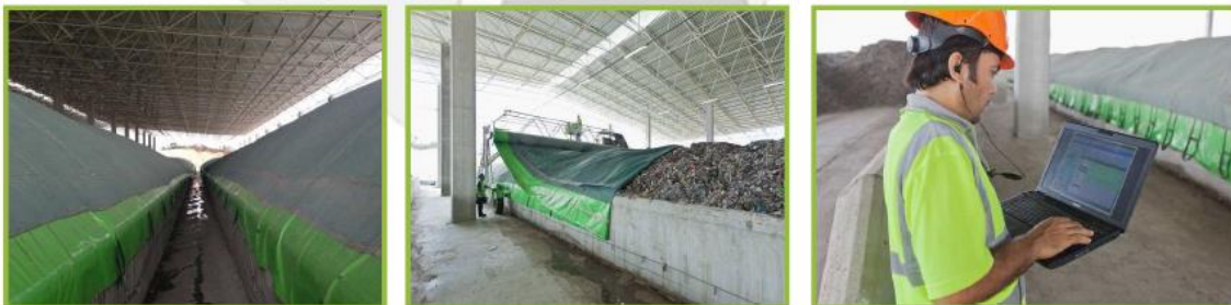
Figura 59 – Vistas do sistema de membranas. Corredor entre trincheiras (esquerda), encapsulamento da leira (meio), controle online (direita).
