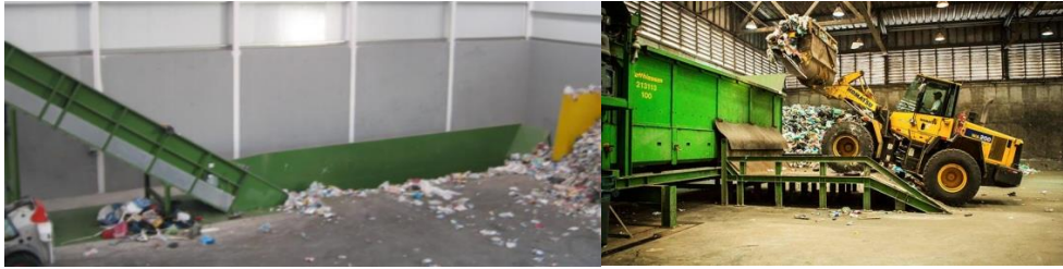
Figura 38 - Alimentador primário enterrado (esquerda) e suspenso (direita).
