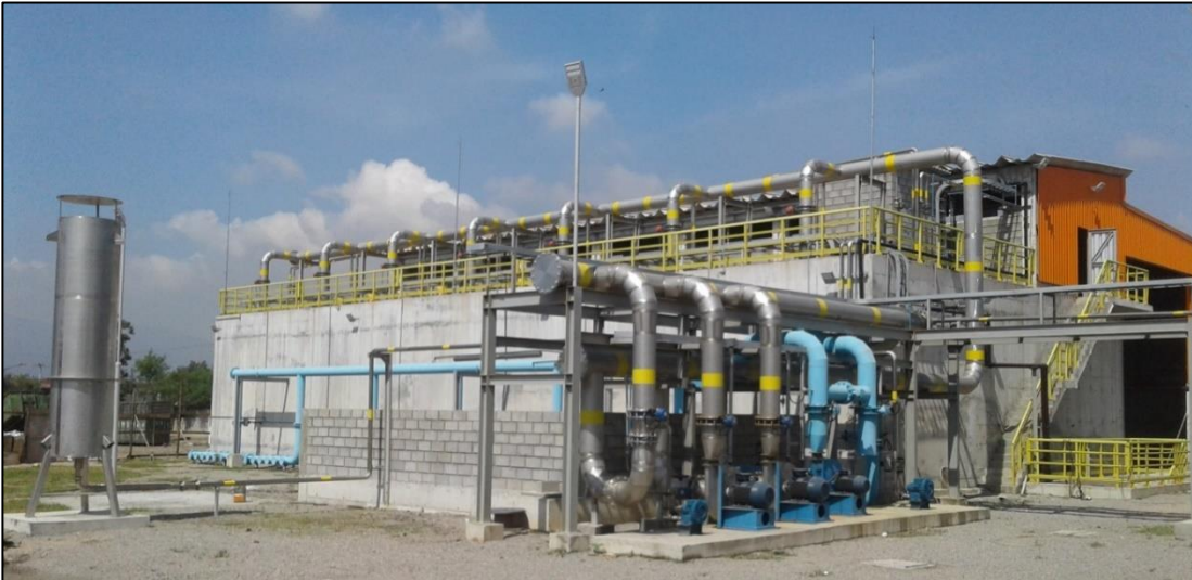
Figura 54 – Detalhes tubulações de biogás e exaustão.
