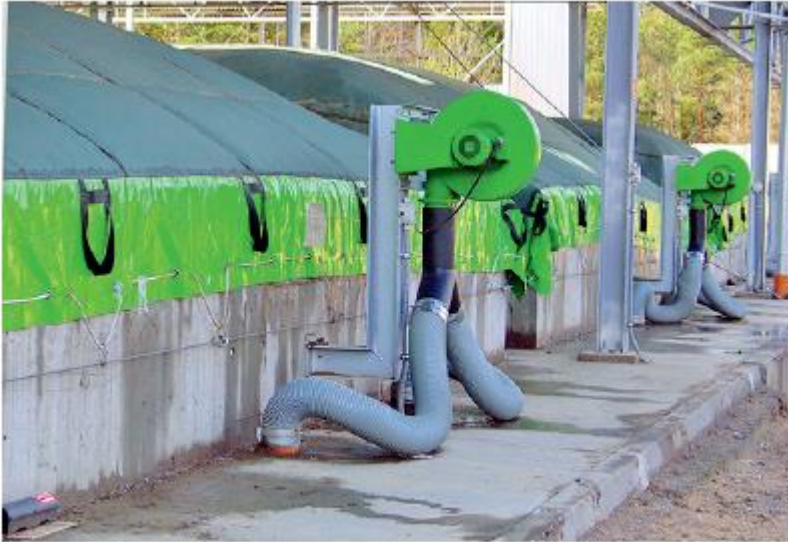
Figura 60 – Detalhe do sistema de aeração do sistema.
