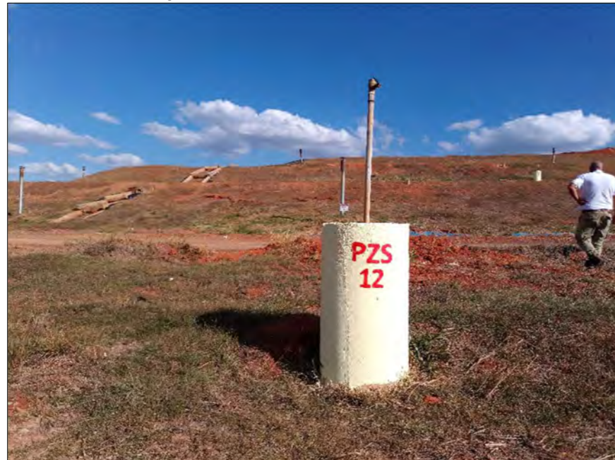
Piezômetro Utilizado para o Monitoramento Geotécnico da Célula do Aterro
