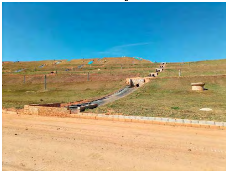
Sistema de Drenagem Pluvial
