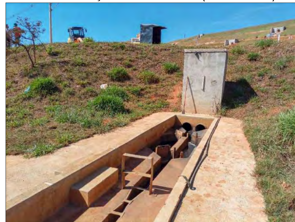
Sistema de Medição de Vazão de Chorume (Medidor Parshall)
