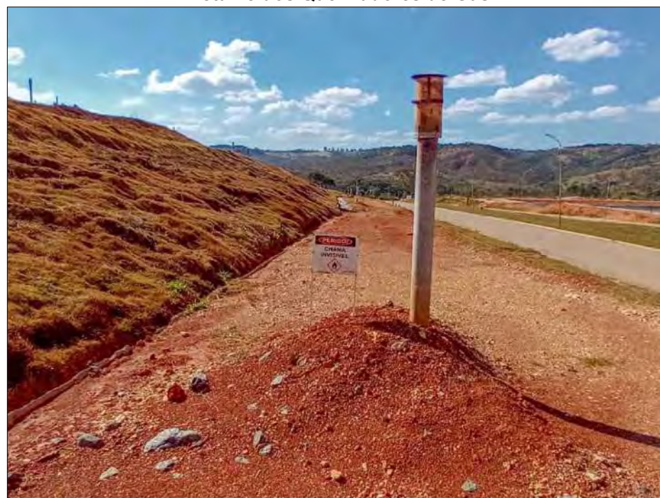
Detalhe dos Queimadores de Gás
