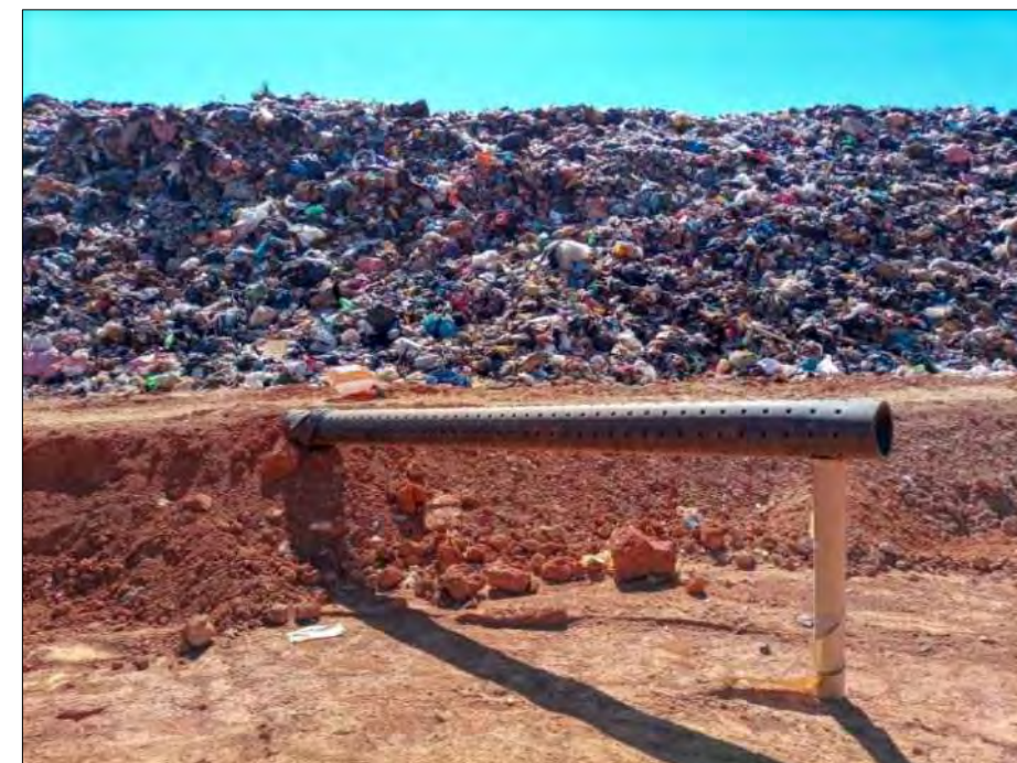
Dreno de Chorume
