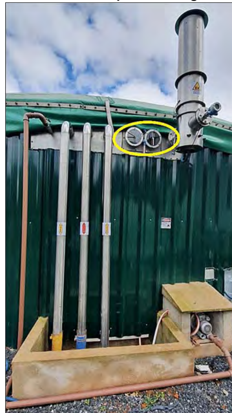
Círculo Amarelo na Parte Superior com o Visor de Inspeção Instalado no Tanque de Biodigestão
