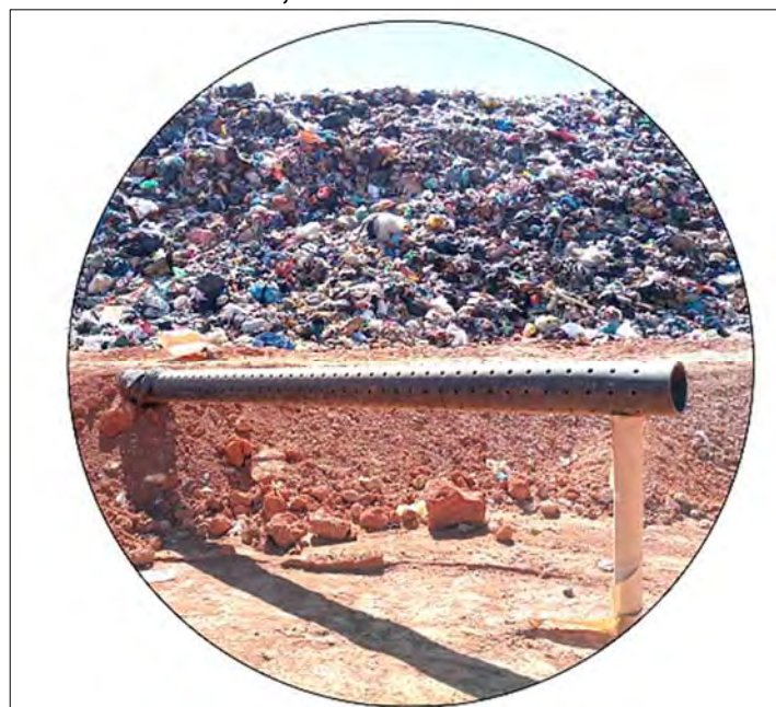
Exemplo dos Drenos de Efluentes, Conforme os Existentes na Atual Célula do Aterro
